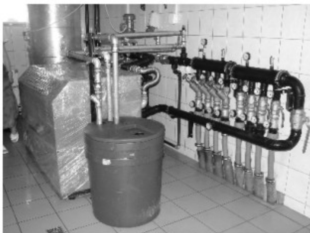
Ekologiczna kotłownia w SP Sierosławice
