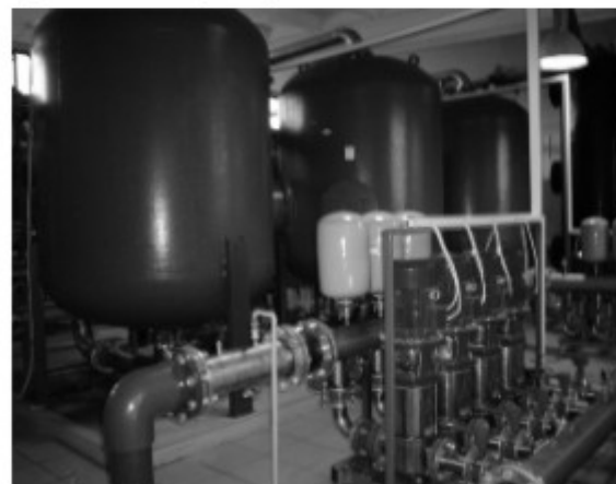
Zmodernizowana stacja uzdatniania wody
